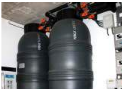
▲ EspaiZero, sala d'acumulació o emmagatzematge energètic. A dalt: bateries per a l'acumulació d'energia elèctrica; a baix, piles d'aigua
