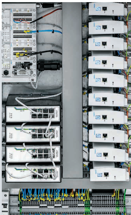
Solución compacta con terminal CPX y controladoras que gobiernan la línea.
