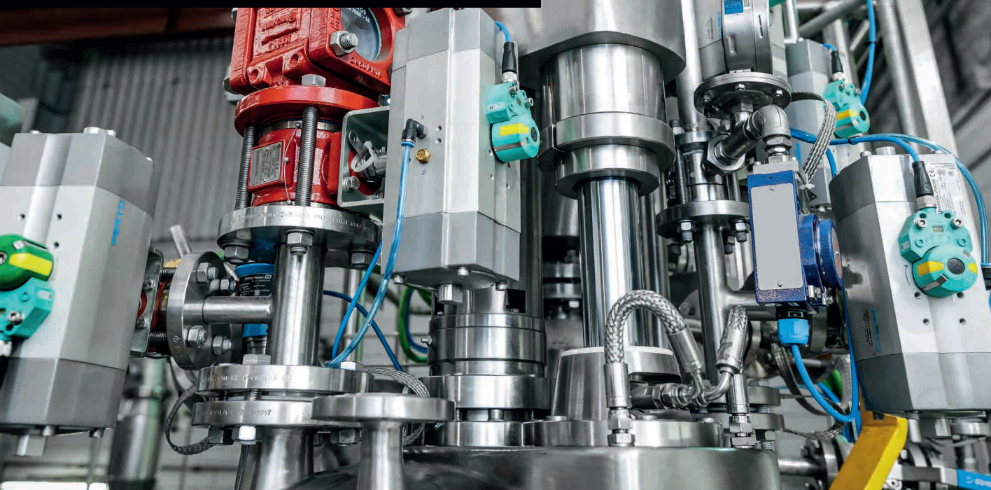
Válvulas de proceso de la línea GMP automatizada por Festo.
