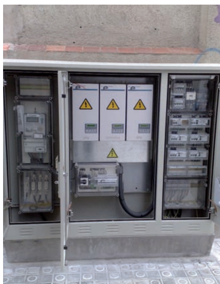
La telegestió de l'enllumenat evitarà emissions de CO 2
