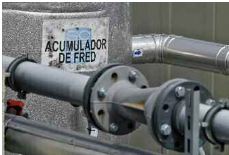
Vista de l'acumulador d'aigua freda generada per la màquina d'absorció
