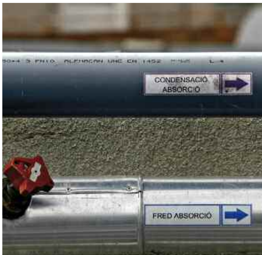
Canonades de connexió als circuits de condensador-absorbidor i evaporador de la màquina d’absorció
