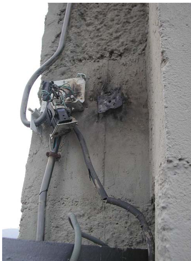
Els llamps tenen efectes electrodinàmics que poden provocar desperfectes
