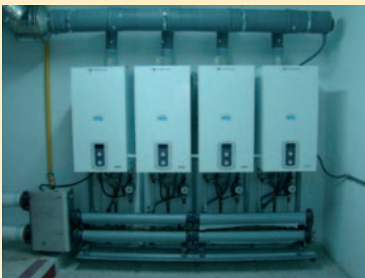
Sala de màquines amb 4 calderes en cascada, model Talia Green System 100 HP.
