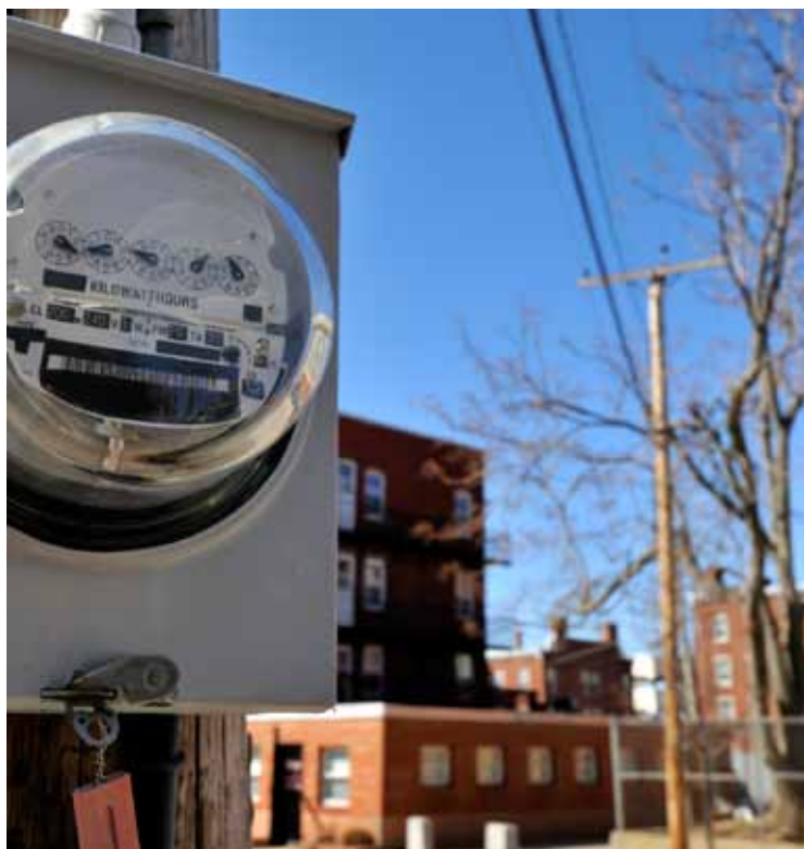
◀ Comptador d'una instal·lació elèctrica urbana.
